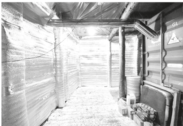
Так сейчас выглядят стены подземного ФАПа
